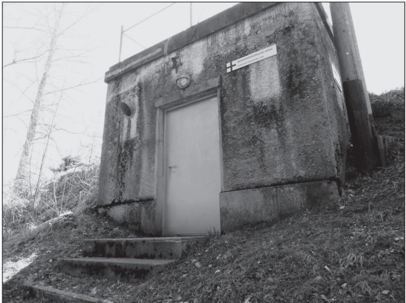
Reservoir Haltenhübeli der WV Köniz aus dem Jahr 1929; zu klein, zu tief gelegen, sanierungsbedürftig
