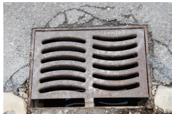
Rissbildung um bestehenden Einlaufschacht. Der Belag wird in Kürze ausbrechen.
