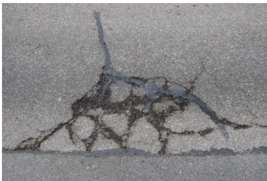
Belagsrisse neben bereits sanierten Rissen offen
