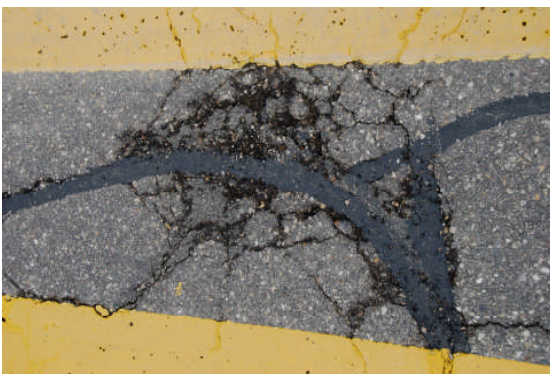
Kornausbruch infolge Alterung des Belages.
