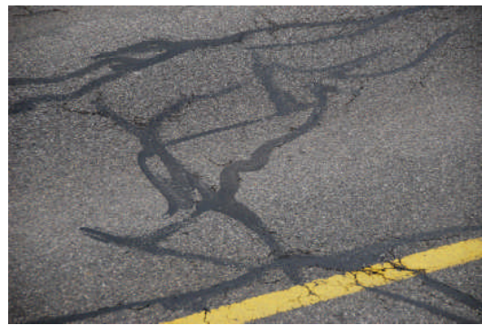
Belagsreparatur z.T. noch geschlossen, Rutschgefahr bei nasser Witterung
