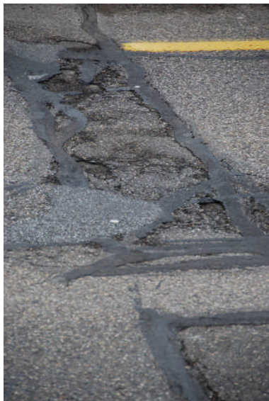
Reparaturstelle auf der gesamten Fahrbahnbreite. Belag bricht aus (Alterung)
