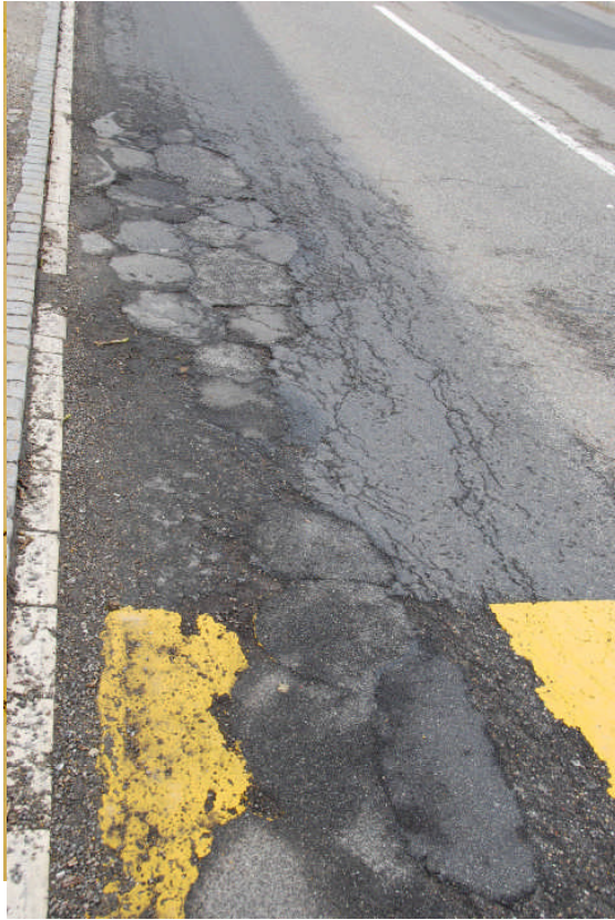
Fussgängerstreifen beim Schulheim Landorf Belagsdeckschicht bricht aus (Alterung).
