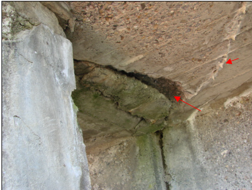
Foto-Nr. 03: Untersicht der Kragplatte. Bei der Dilatationsfuge ist infolge von Betonabplatzungen ein Loch entstanden. Es sind starke Kalkaussinterungen zu sehen.
