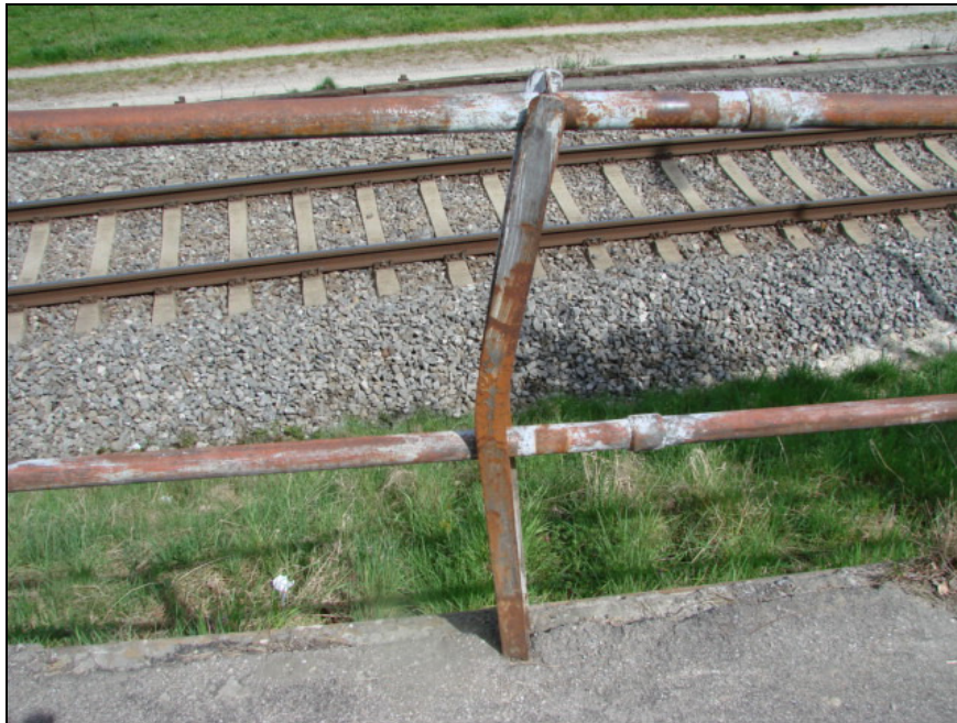
Foto-Nr. 17: Geländer. Das Geländer ist lokal stark verbogen. Zudem ist es korrodiert.
