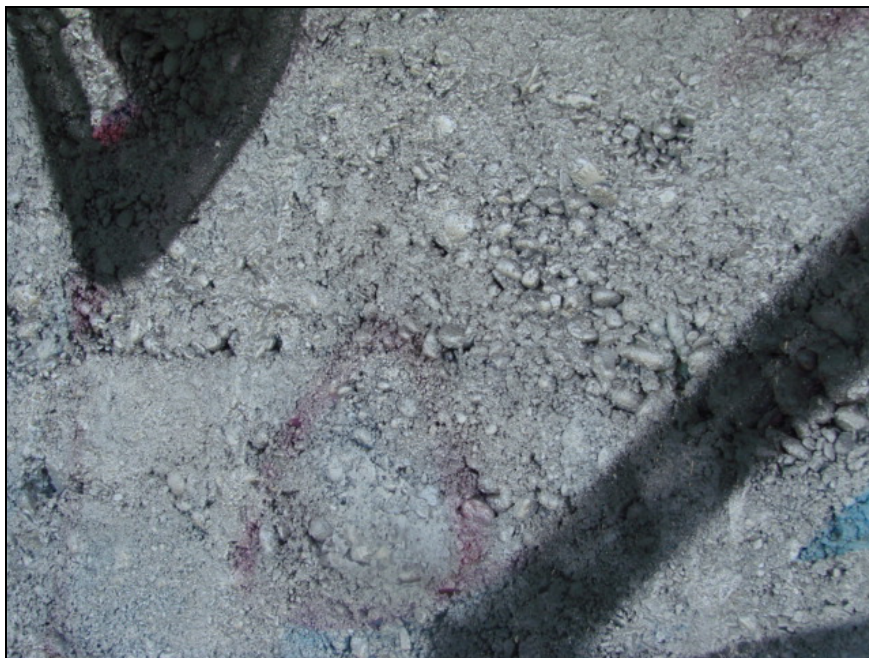
Foto-Nr. 10: An der Stützmauerwand löst sich die Zementhaut ab. Die Oberfläche ist teilweise mit Graffiti versprayt.
