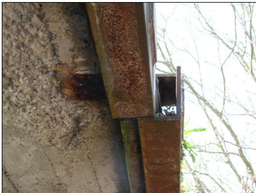
Foto-Nr. 13: Verstärkungsmassnahmen. Die Stahlwinkelprofile an der äusseren Kragplattenkante haben sich stark verschoben. Die Funktion ist nicht mehr gewährleistet!
