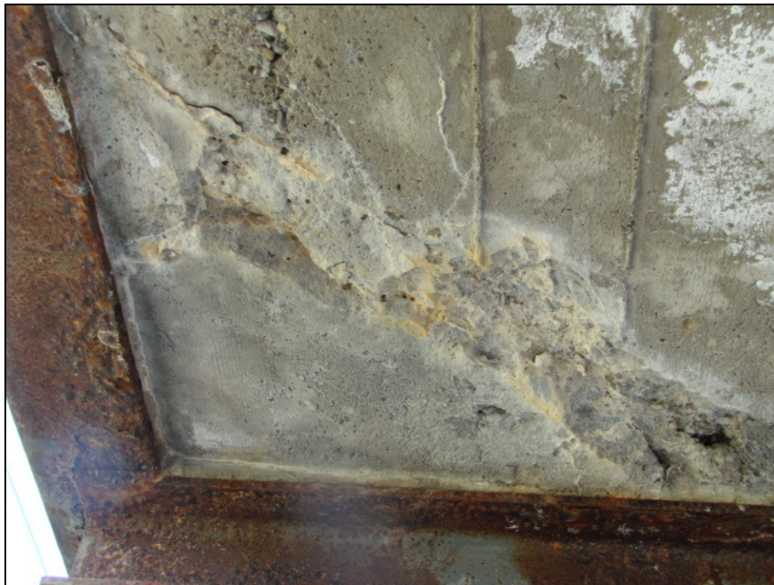
Foto-Nr. 08: Untersicht der Kragplatte. Riss mit Kalkaussinterungen und Salzausblühungen.
