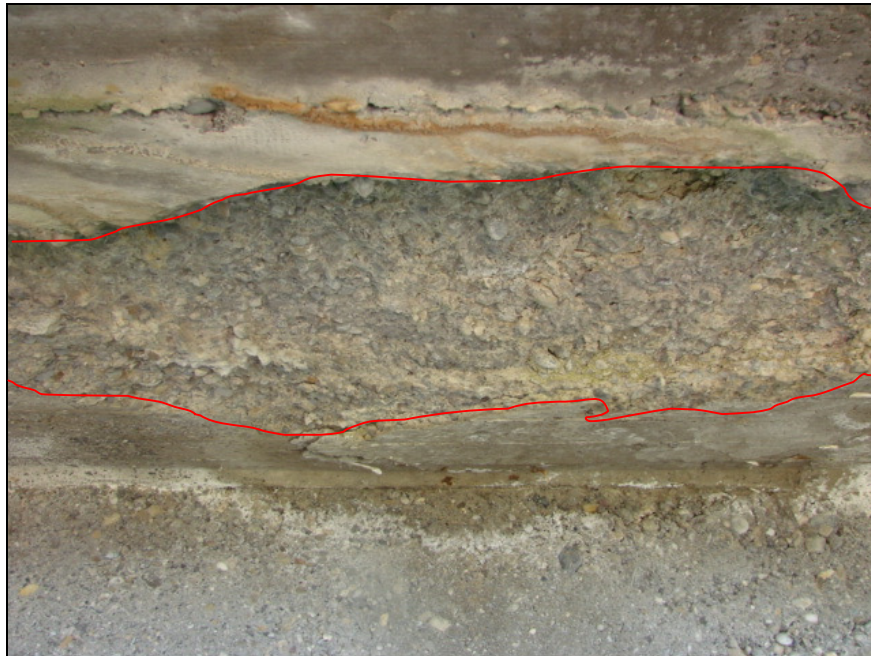
Foto-Nr. 01: Untersicht der Kragplatte. Sehr grosse Betonabplatzung 2.00 m x 0.50 m und 7 cm tief.
