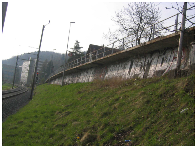
Beilage 1, Hauptinspektion 2007, Zustandsrapport Kunstbauten.
