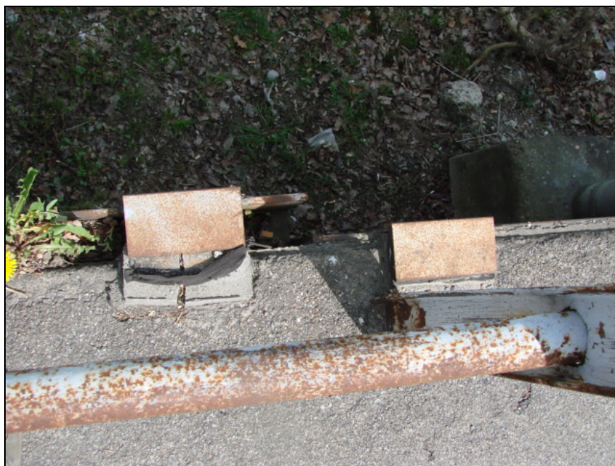
Foto-Nr. 14: Verstärkungsmassnahme. Situation von oben her gesehen. Der Auflagerwinkel liegt kaum noch auf der Kragplatte auf. Die Funktion ist nicht mehr gewährleistet!
