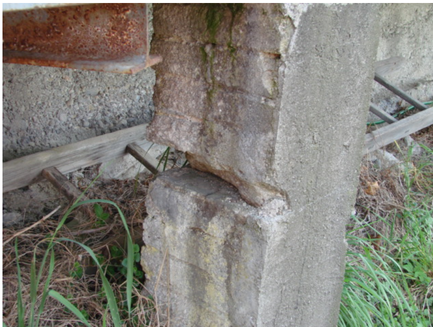
Foto-Nr. 12: Auch die andere Auflagerstütze ist in einem schadhafte Zustand. Hier fehlt ebenfalls ein Mauerwerkstein.
