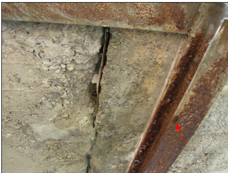
Foto-Nr. 06: Untersicht der Kragplatte. Die Verstärkung neben der Dilatationsfuge weist Korrosionserscheinungen auf. Es sind erste Anzeichen von Querschnittsverlust erkennbar.
