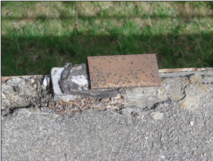
Foto-Nr. 15: Verstärkungsmassnahme. Das Mörtelbett des Auflagerwinkel hat sich stark verschoben. Rundherum ist der Belag abgeplatzt.
