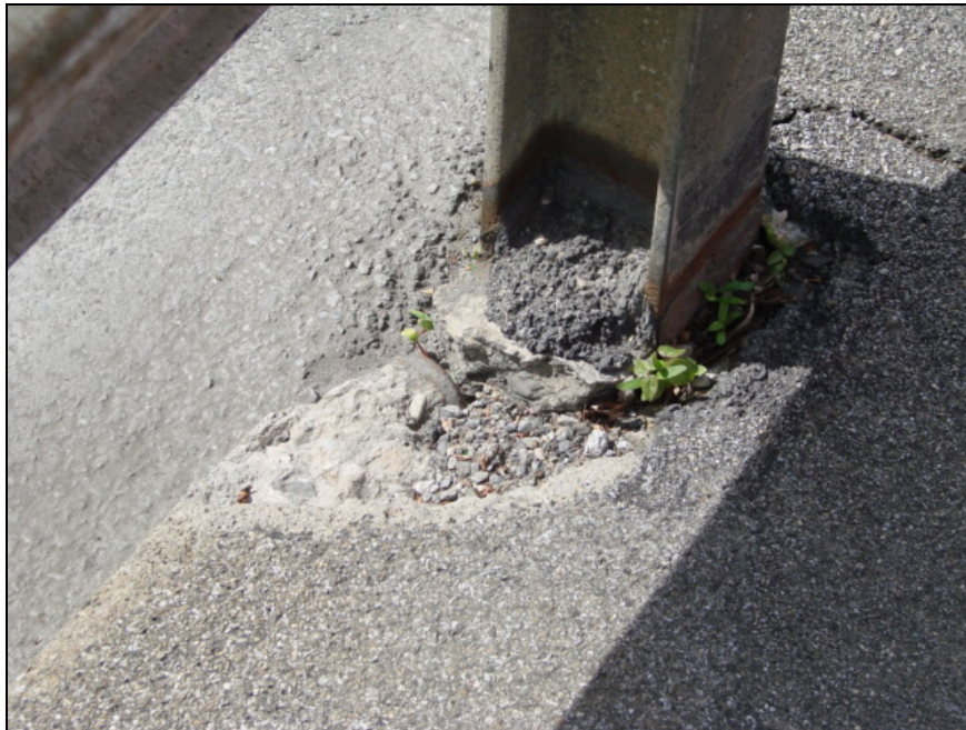
Foto-Nr. 21: Fahrzeugrückhaltesystem. Die Posten des Fahrzeugrückhaltesystems sind einbetoniert, an den meisten Posten ist es zu Abplatzungen gekommen.
