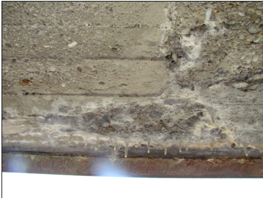
Foto-Nr. 09: Untersicht der Kragplatte. Riss mit starken Kalkaussinterungen ausserhalb einer Dilatationsfuge.
