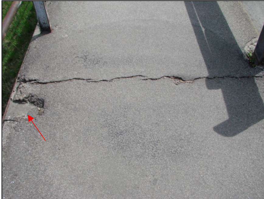
Foto-Nr. 19: Oberseite. Bei der Dilatationsfuge ist ein Riss entstanden. Es gibt zudem viele Belagsabplatzungen am Kragplattenrand.
