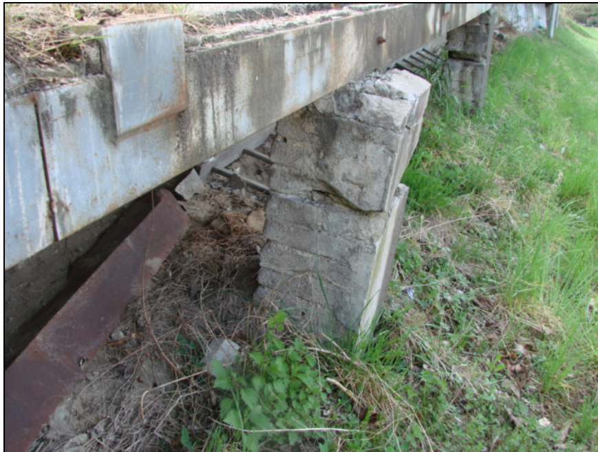
Foto-Nr. 11: Diese Stütze hat sich stark verschoben. Zudem hat sich ein Mauerstein gelöst. Die Tragsicherheit ist nicht mehr gewährleistet!
