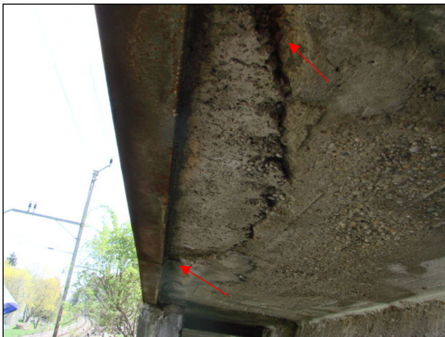
Foto-Nr. 05: Untersicht der Kragplatte. Es gibt grosse Flickstellen, die teilweise wieder erhebliche Schäden aufweisen.
