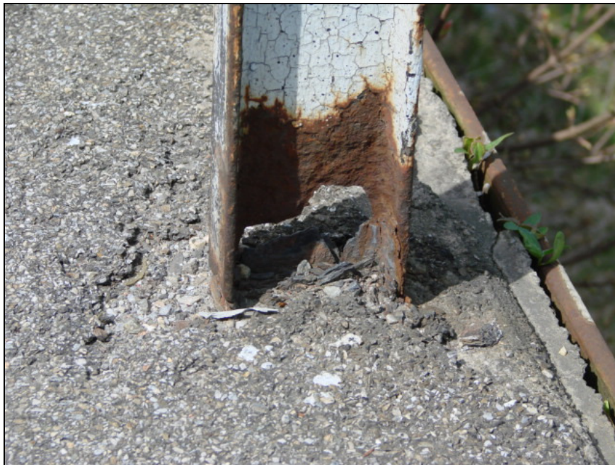
Foto-Nr. 18: Geländer. Die Geländerposten weisen an mehreren Stellen massive Lochfrasskorrosion auf. Die Sicherheit ist gefährdet!
