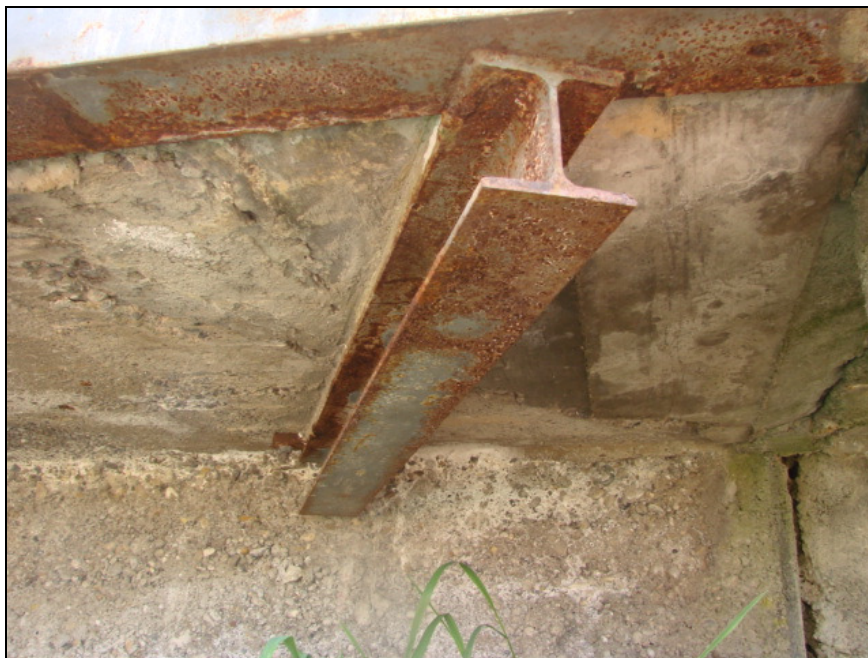
Foto-Nr. 04: Untersicht der Kragplatte. Verstärkungsmassnahmen.
