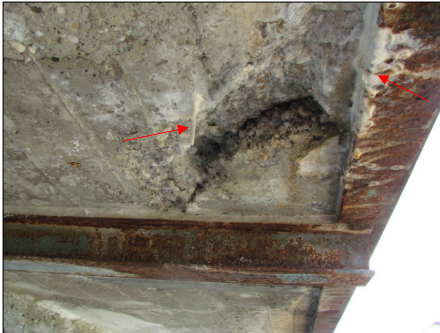
Foto-Nr. 07: Untersicht der Kragplatte. Grosse Betonabplatzung im Bereich der Verstärkungsmassnahme. Starke Kalkablagerungen mit Stalaktitenbildung. Die Verstärkungsmassnahme ist korrodiert.
