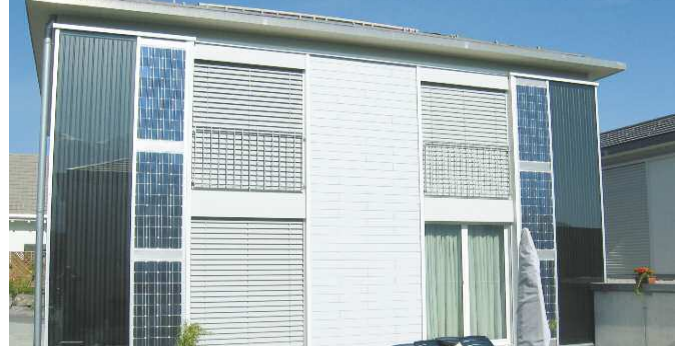
Solaranlage an Fassade
