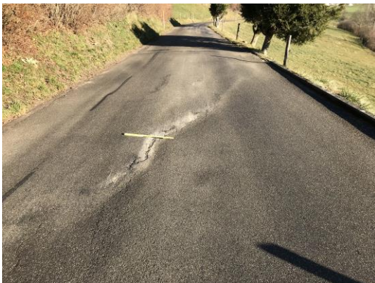
Schadensbilder im Teil A
