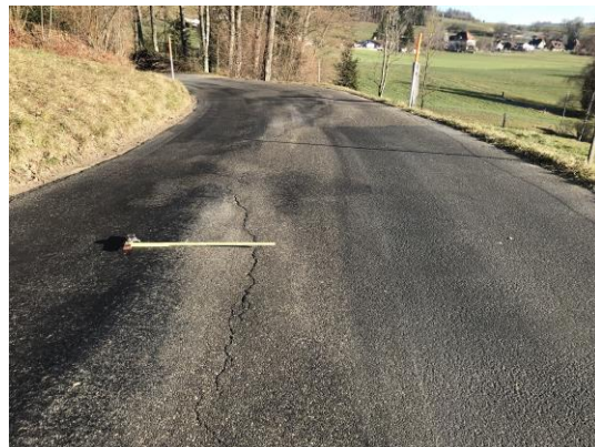
Schadensbilder im Teil B
