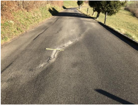
Schadensbilder im Teil A
