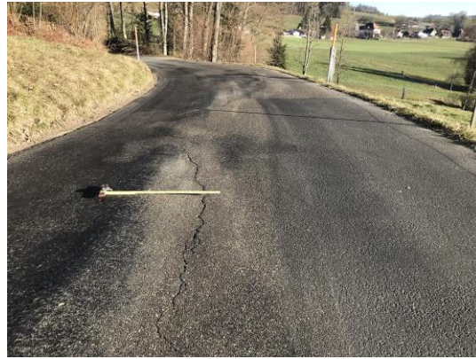
Schadensbilder im Teil B
