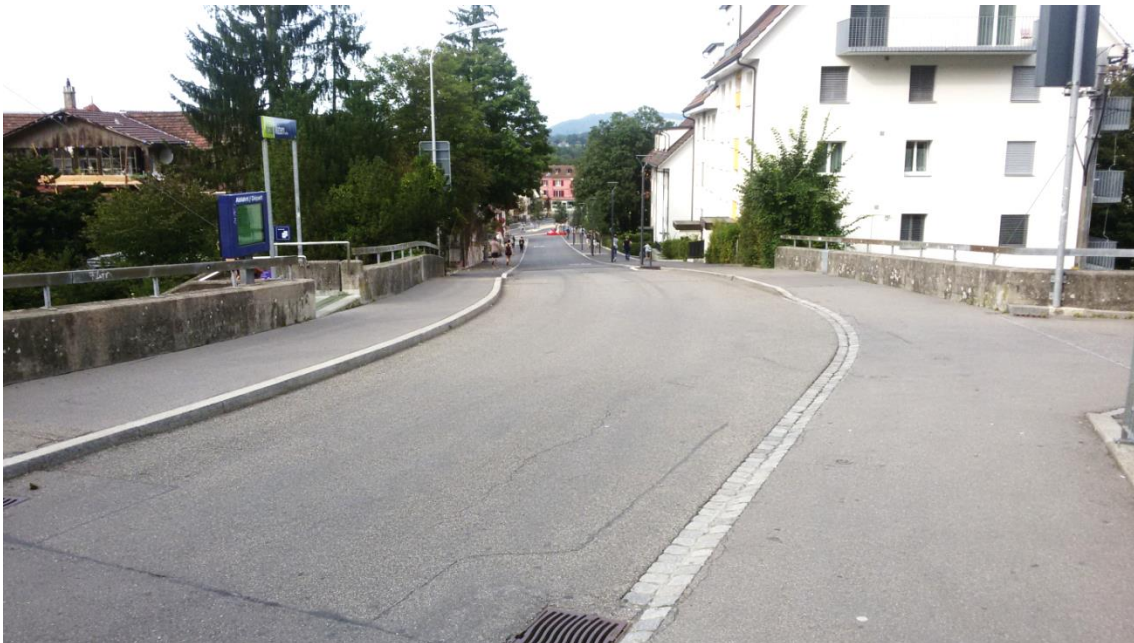
Abbildung 6: Dorfstrassebrücke – am unteren Ende zu sehen ist der Übergang vom bereits erneuerten Belag zum nicht erneuerten Belag.
